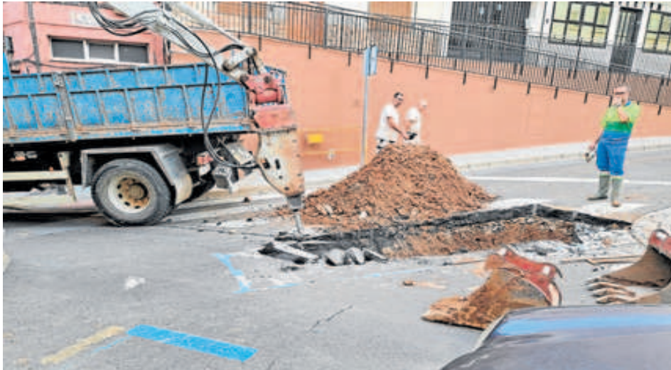
Máquina perforando ayer el asfaltado de la calle Badajoz esquina Vespasiano por una avería. HOY
